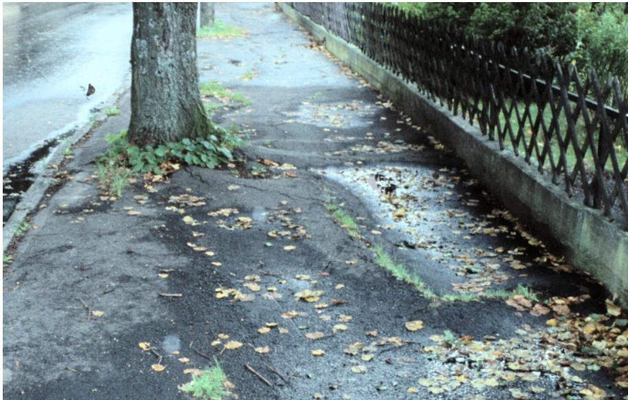
Bei schlechten Bodenverhältnissen wachsen Strassenbäume dort, wo Luft und Feuchtigkeit vorhanden sind, d.h. im Sand direkt unter der Oberflächenschicht. Die immer größer werdenden Wurzeln drücken den Belag nach oben und spalten die Oberflächenschicht.
