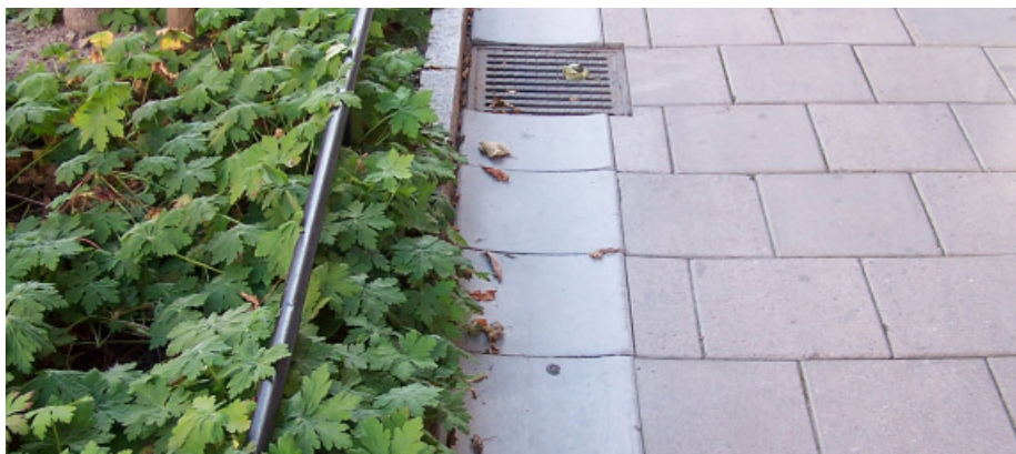
Die Abbildung zeigt wie Niederschlagswasser von Hausdächern über ein Fallrohr an der Fassade zum Luftbrunnen neben der Pflanzfläche geleitet wird. Die Wasserrinne wurde als Tiefpunktlinie mit schalenförmigen Betonplatten gelegt. Der Brunnen ist ein so genannter Luftbrunnen und versorgt die Pflanzen mit sowohl Wasser als auch Luft. (Foto: Björn Embrem)
