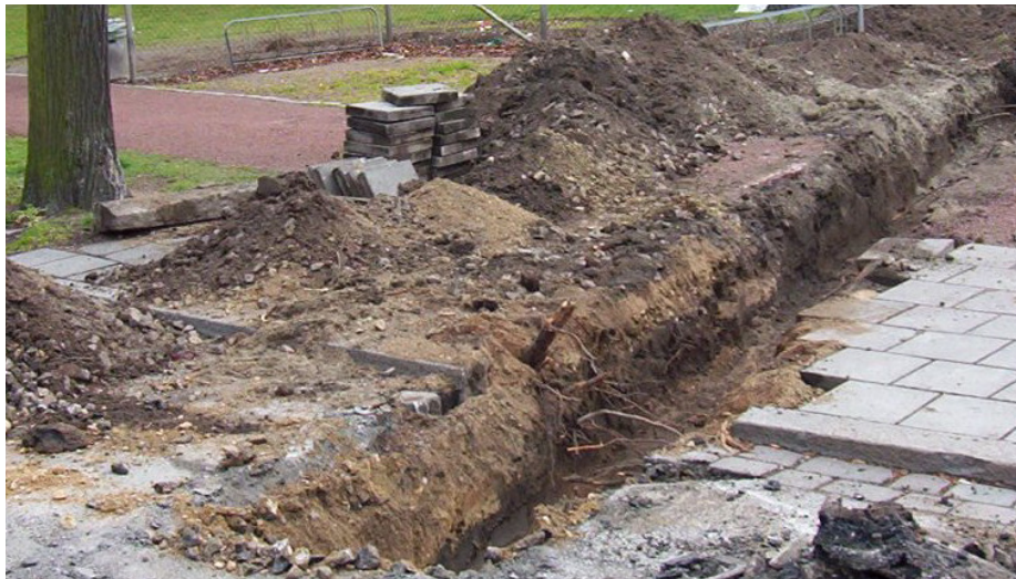
Falsch ausgeführter Schachtgraben 5 m vom Baumstamm entfernt. Grobe Wurzeln wurden abgegraben, kein Schutz gegen Austrocknung vorhanden. (Fotos: Örjan Stål)
